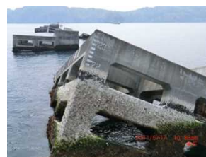
津波で破壊された 釜石湾口防波堤
